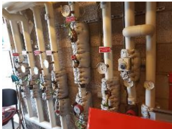
Isolatie leidingen en appendages
