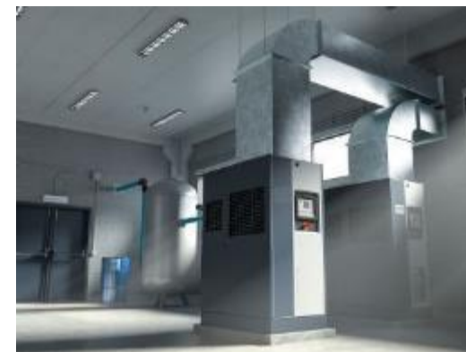
Aanzuigen koele buitenlucht compressor (perslucht)
