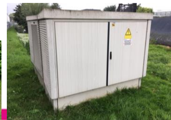
MS Net/Distributiestation van 10 kV naar 400/230 Volt
