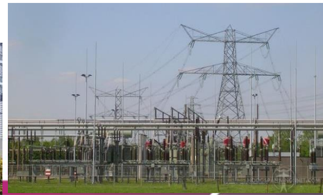
Hoogspanningsstation Van 110 kV naar 10 kV
