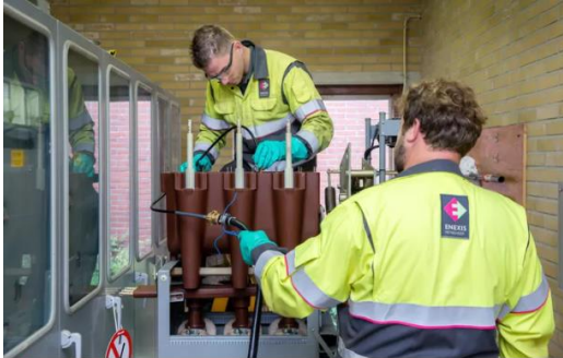
▲ Monteurs van Enexis aan het werk in een middenspanningsstation. © Enexis
