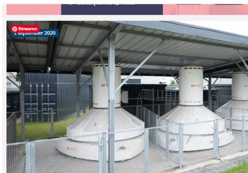
Leclanché en S4 Energy leveren energieopslagsysteem in Almelo
